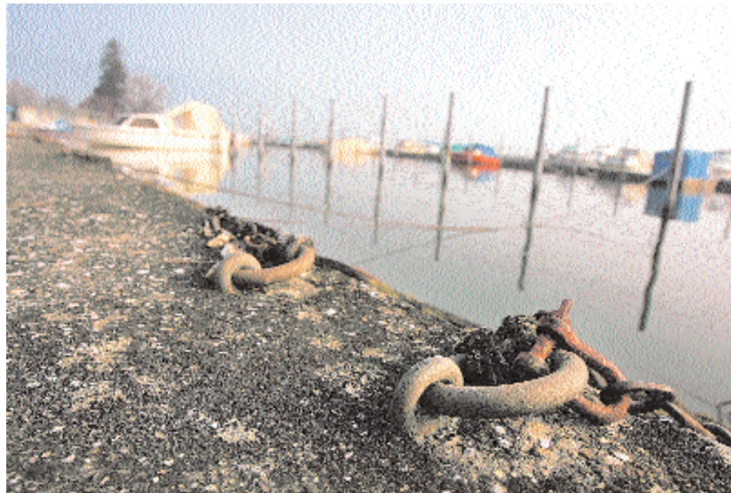
Die 30-jährige Hafenanlage in Erlach muss erneuert werden. Ein Grund ist, dass die Sicherheit nicht mehr den heutigen Ansprüchen genügt.
